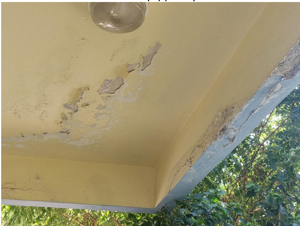
Εικ 2. Φθορές από υγρασία στον σοβά του εξώστη στην κύρια όψη (νοτιοδυτικά)
