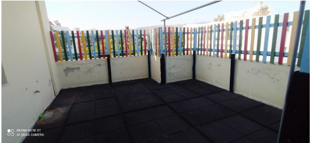
Εικ 3. Φθορές από υγρασία στο στηθαίο της βεράντας του Β' ορόφου (νοτιοδυτικά)
