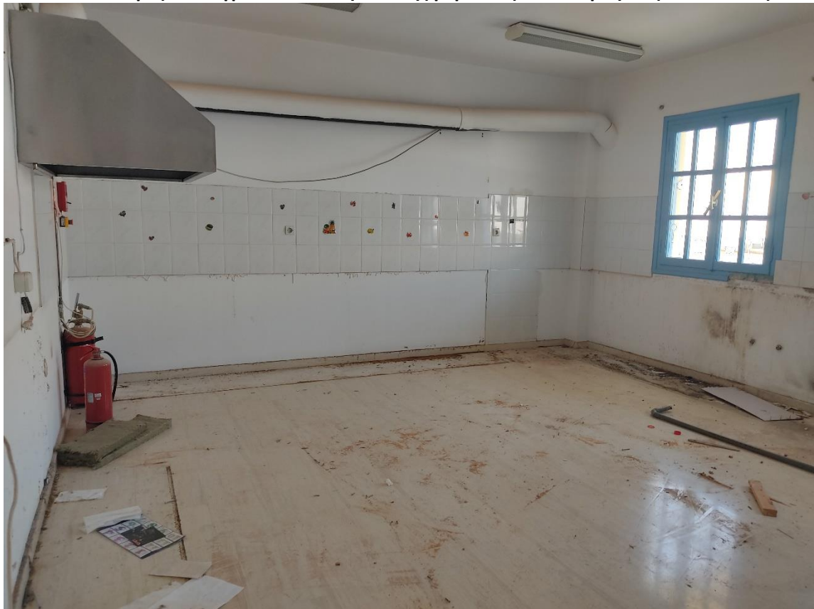
Εικ 4. Κουζίνα, φθορές στα πλακίδια τοίχου
