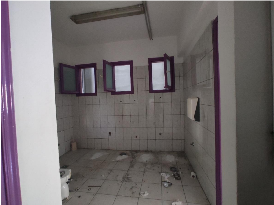
Εικ 7. WC, φθορές στα πλακίδια τοίχου και δαπέδου
