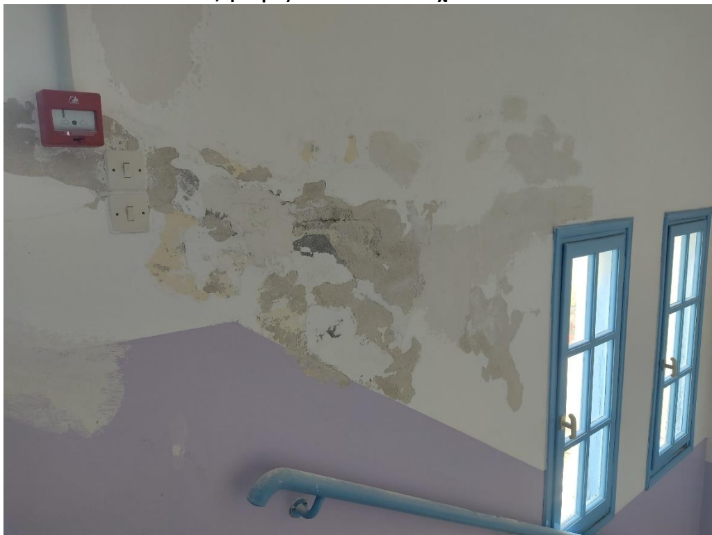
Εικ 8. Κλιμακοστάσιο, φθορές στον τοίχο από υγρασία
