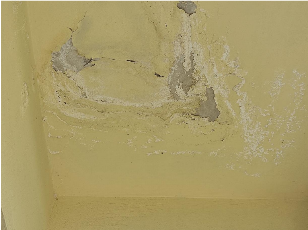
Εικ 5. Φθορές από υγρασία στον σοβά της οροφής εσωτερικά, νοτιοδυτικά του κτιρίου.
