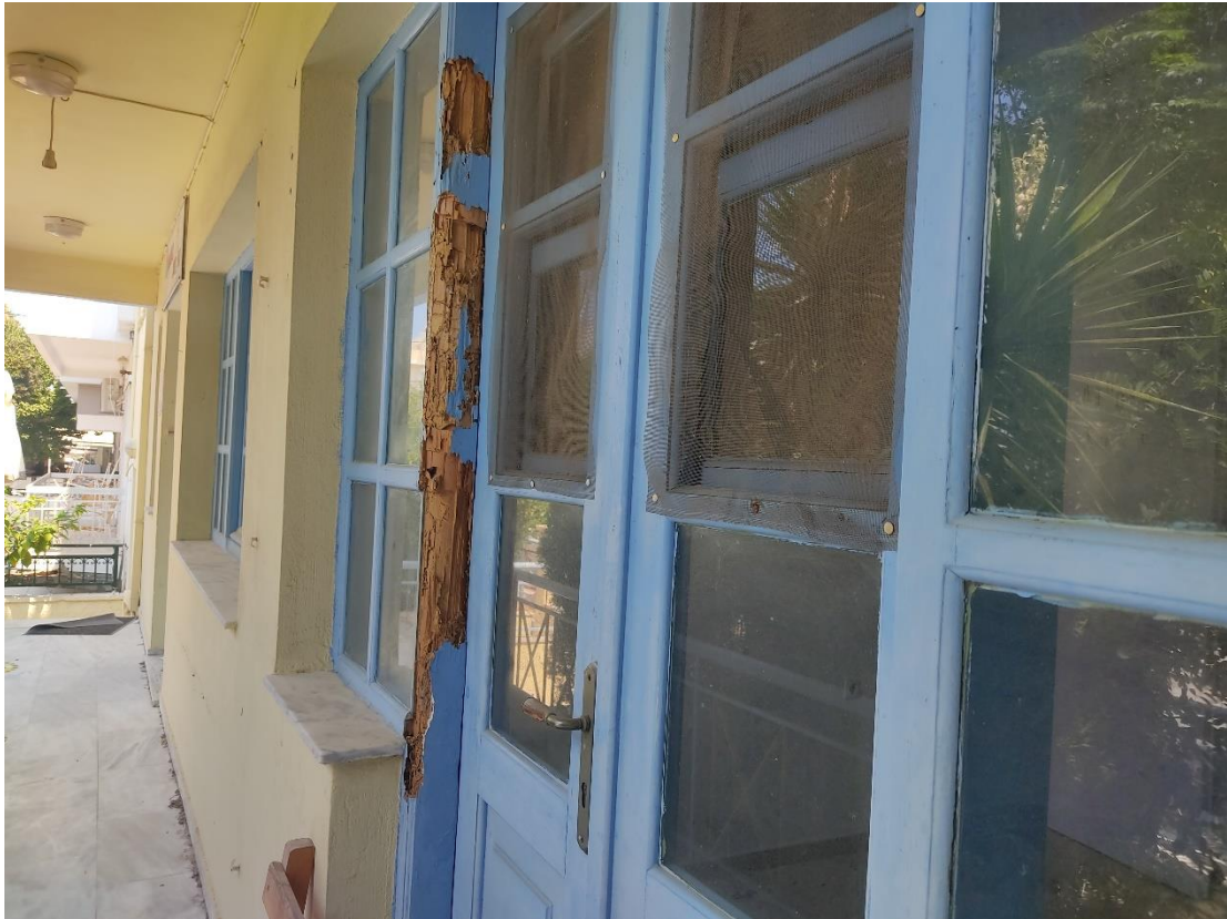
Εικ 9. Αποσάθρωση στο ξύλινο κούφωμα από υγρασία
